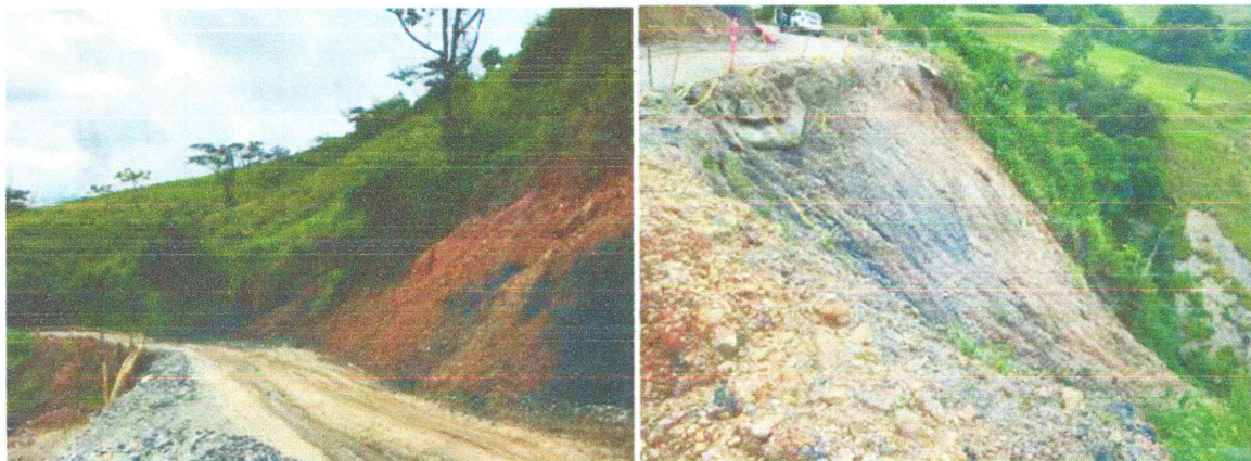
Pérdida de banca PR3+91 Fuente: Toma propia
