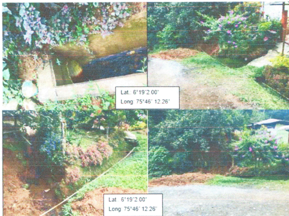
Tuberías 12" y 10" aguas lluvias y sanitarias Fuente: Elaboración propia
