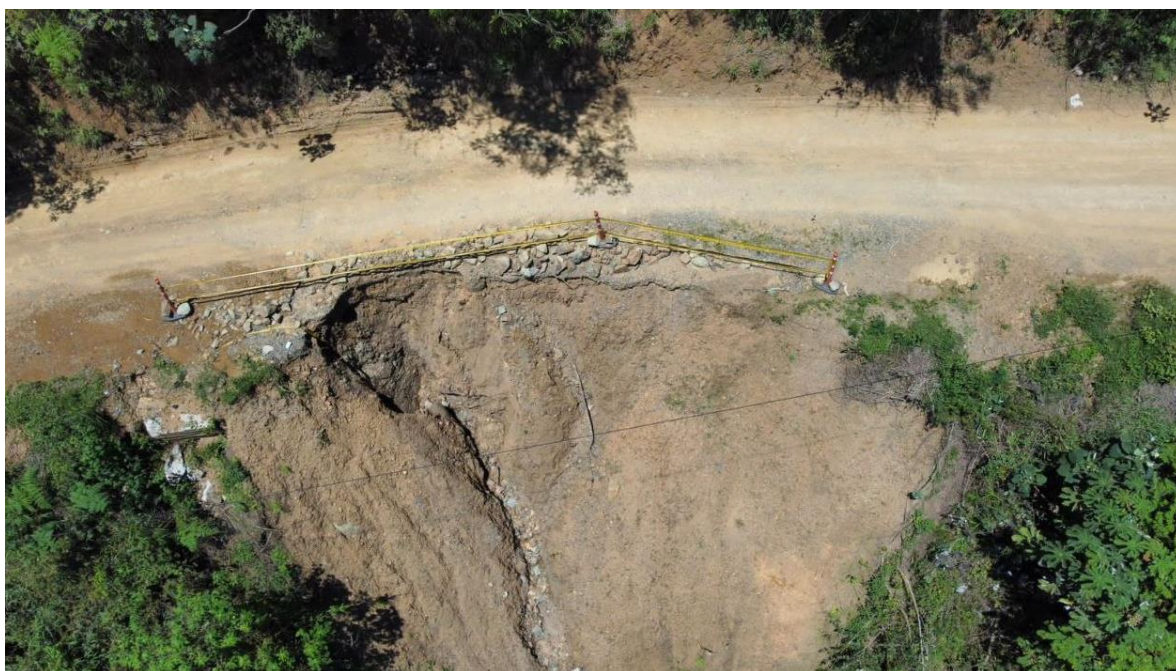
Figura 2. Condición actual de la zona de estudio PR15+930.
