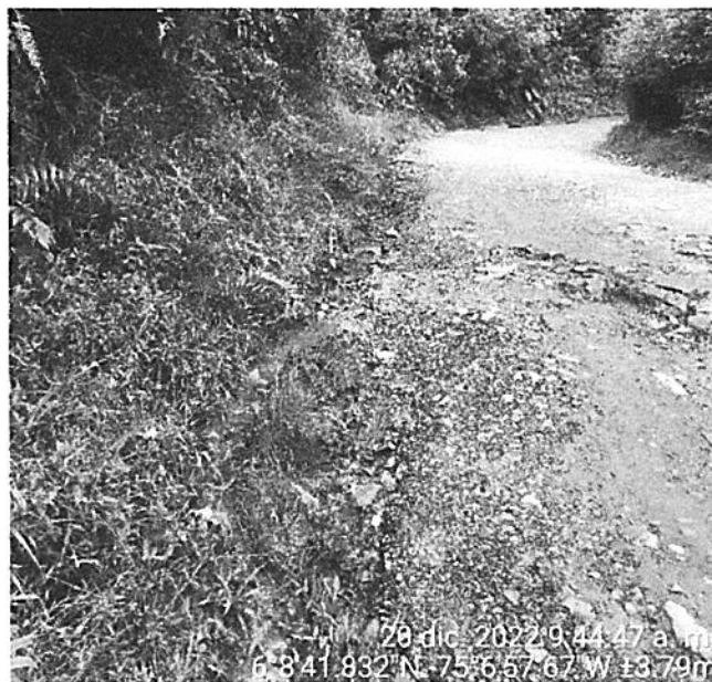
Foto 2. Presencia de agua en el costado izquierdo según el absclisado (vista en sentido hacia San Carlos).
