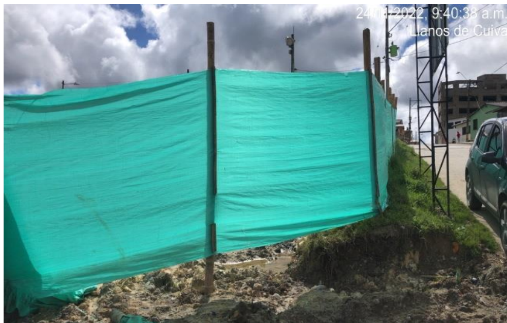
Foto 19. Reparación de cerramiento dañado.
