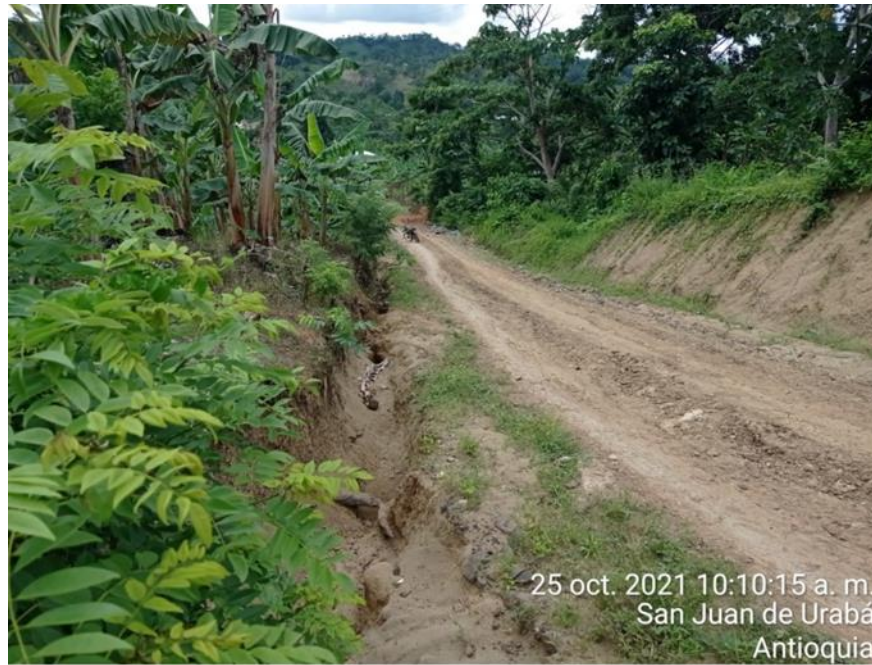
Fotografía 16 Zona crítica de erosión presente en el terreno
