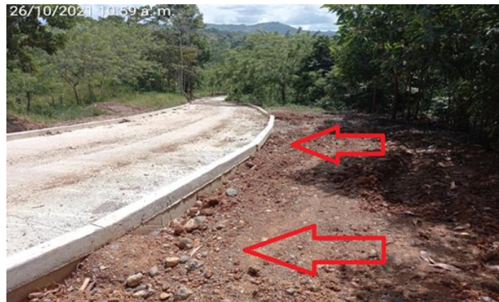
Fotografía 25 Ubicación de zonas críticas de erosión Frente de obra san pedro- santa rosa tramo 2- SAN PEDRO
