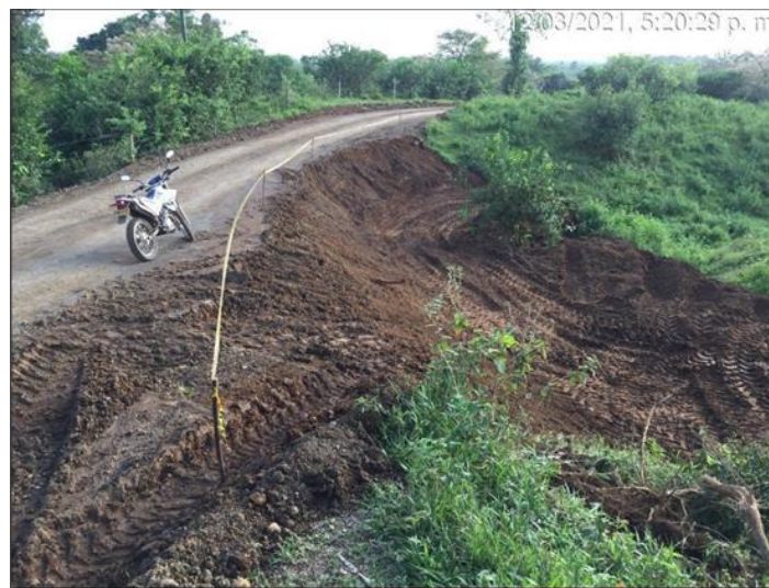
Fotografía 13 Pérdida de banca – Chadó Arriba (Mutatá)
