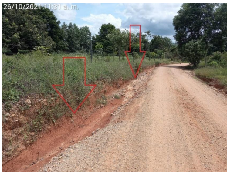
Fotografía 27 Ubicación de zonas críticas de erosión Frente de obra san pedro- santa rosa tramo 1- SAN PEDRO
