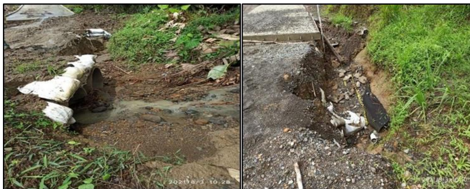
Fotografía 18 socavación por flujos de agua municipio de Turbo, Antioquia
