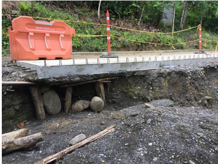
Fotografía 1 Pérdida de banca por movimiento de talud.
