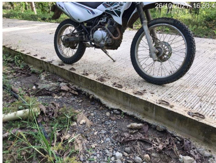
Fotografía 2. Erosión lateral de los bordillos
