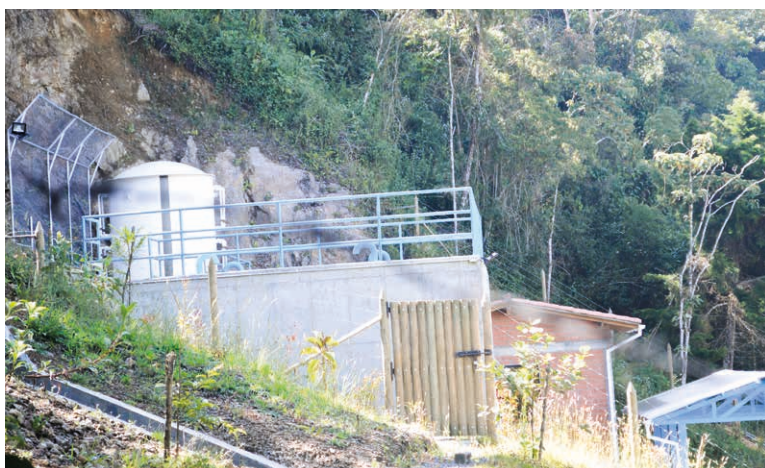
Figura 14. Acueducto veredal de Envigado
