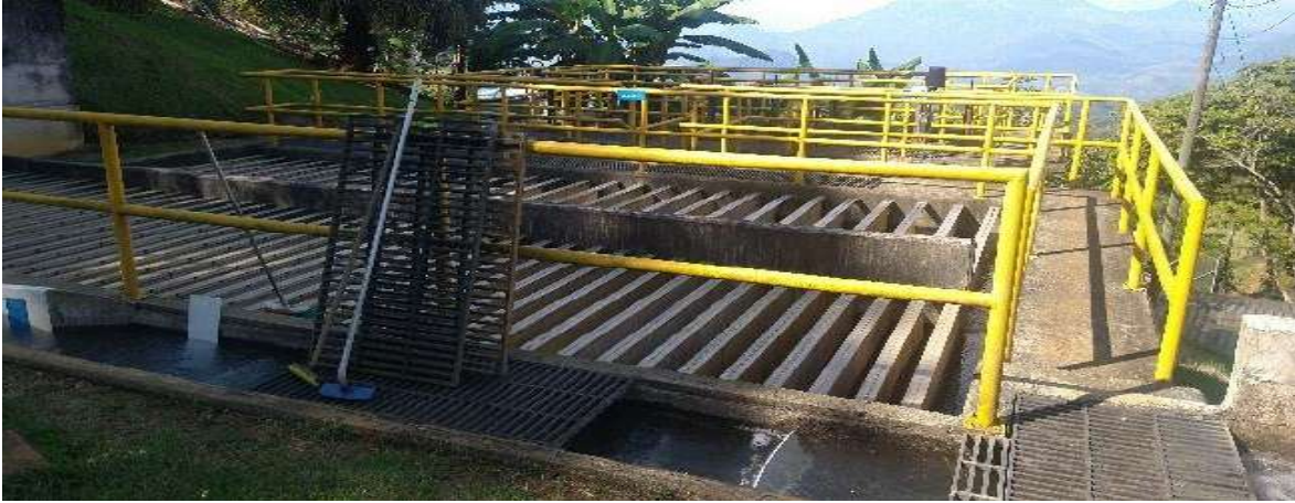
Figura 36. Acueducto veredal La Linda.
