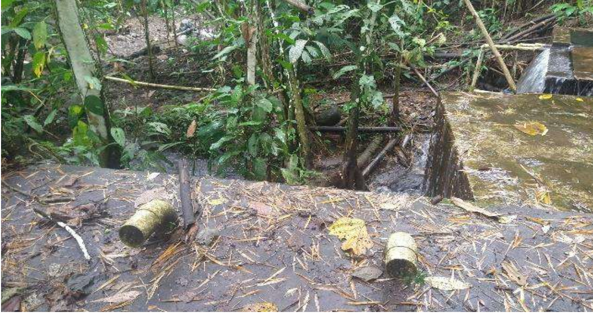
Figura 48. Tanque de almacenamiento.
