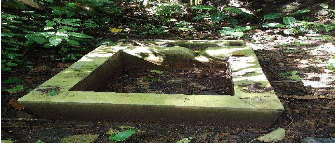
Figura 42. Tanque de almacenamiento.
