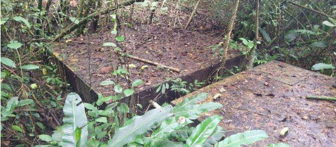
Figura 46. Tanque de almacenamiento.
